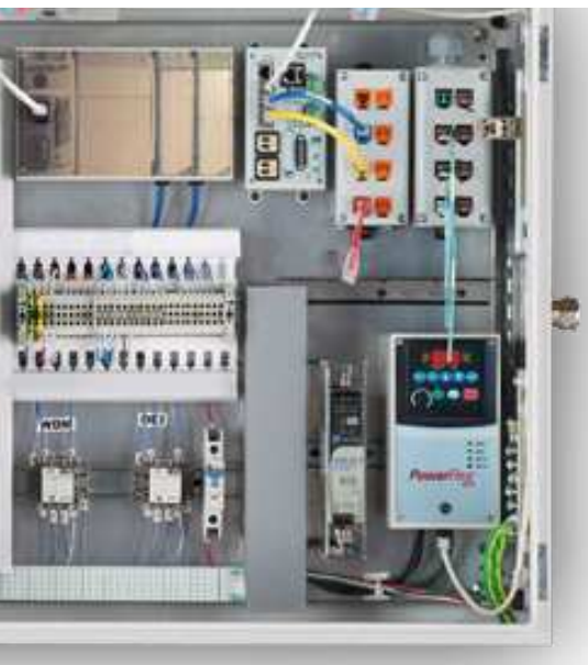
tủ điện, thiết bị điện electrical equipment
